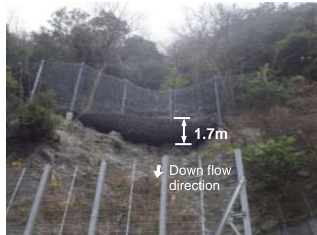
Fig. 10 Capture case of collapsed sediment (d)
