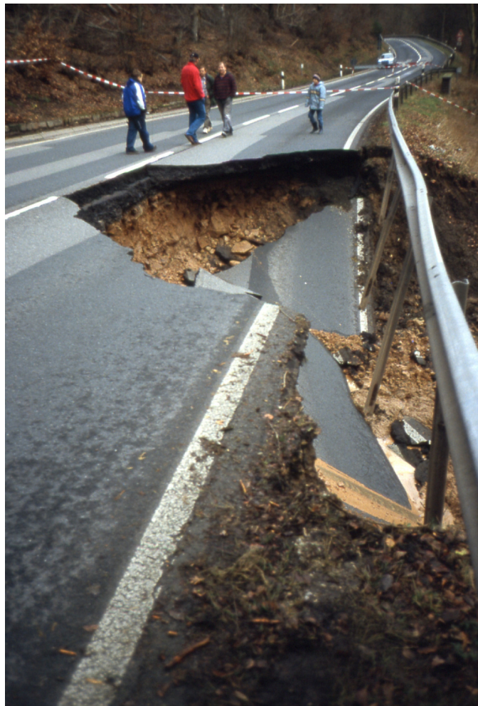
Fig. 4 Rutschungsschaden an der Bundesstraße 3 bei Hann. Münden im Januar 2003 (Damm, 2011)
