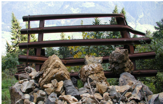
Fig. 6 Steinschlag zerstörte eine Steinmauer und beschädigte weiter unten Stahlschnee-brücken (Photo C. Rönnau)
