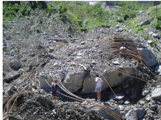
Fig. 6 Destruction of deflecting walls in 2006 Fig. 6 Destruction des dents défectrices en 2006
