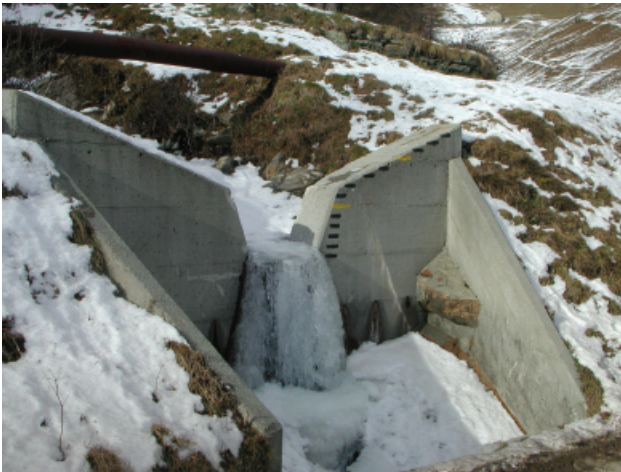
Abb. 4: Manuelle Pegelmessstelle im Gebiet Simplon Süd Fig. 4: Human readable water level control point in the test area Simplon Süd
