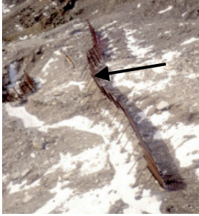
Abb. 2: Stützverbauungen in einem Kriechhang mit Deformationen von mehr als 1.0 m. Wisse Schijen Randa. Fig. 2: Supporting structures built on a slope with creep deformations of more than 1.0 m. Wisse Schijen Randa.
