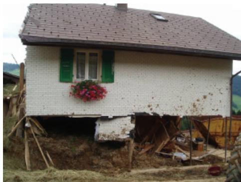
Abb. 3: Vollständig zerstörtes Wohnhaus in Schüpfheim (Foto: Egli Engineering).
