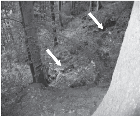
Abb. 1: Photo September 2005. Hornweg Richtung Süden bei ca. 950 m ü.NN. Die Pfeile markieren einen Anbruchbereich mit Rissbildungen. (Photo Forstamt Immenstadt)
