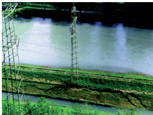
Abb. 8: Grundbrucherscheinungen mit Böschungsfussrutschungen am Linthkanal, Hochwasser 1999: Szenario für obige Überflutungsmodellierung.
