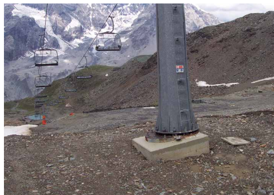
Cedimento del terreno e conseguente addattamento delle fondazioni. Foto: A. Zischg
