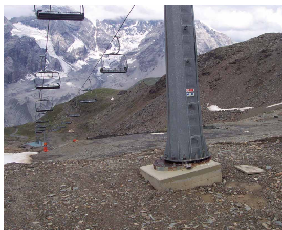
Subsidence du sol et ajustement des fondations d'un pylône. Photo: A. Zischg
