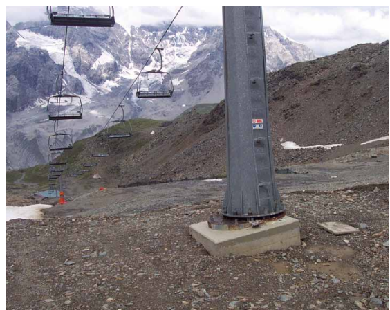
Bodensenkung und darauf folgende Anpassung des Fundaments. Foto: A. Zischg
