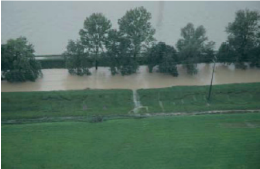
Abb. 5: Rechter Hintergraben, Hochwasserereignis August 2005: Ein Dambruch hätte mit grosser Wahrscheinlichkeit auch den Bruch des Hauptdammes zur Folge. Fig. 5: The right backside trench during the flood in August, 2005. A dam break would have most likely caused the break of the main levee as well.
