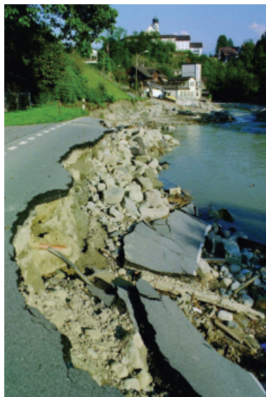
Abb. 8: Die Kleine Emme riss im August 2005 bei Werthenstein (Kanton Luzern) die Strasse mit.
