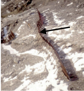
Abb. 2: Stützverbauungen in einem Kriechhang mit Deformationen von mehr als 1.0 m. Wisse Schijen Randa. Fig. 2: Supporting structures built on a slope with creep deformations of more than 1.0 m. Wisse Schijen Randa.
