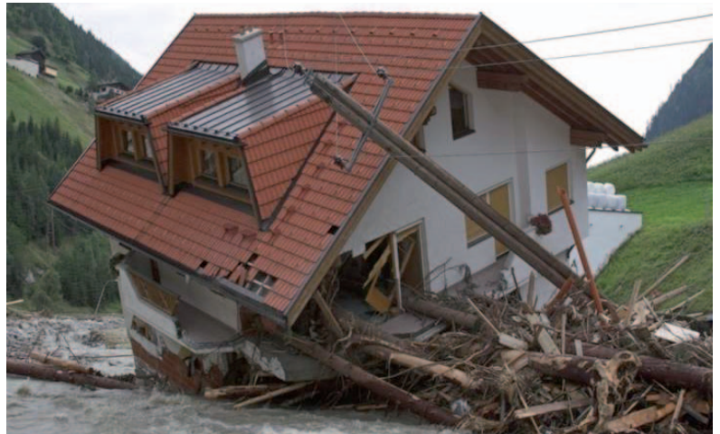
Gebäudeschaden an der Trisanna, Hochwasser 2005 (Foto: WLV Tirol)
