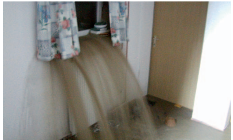
Wassereintritt in ein Gebäude kann durch Verklauung mit Rückstau verursacht werden (Foto: WLV Tirol)
